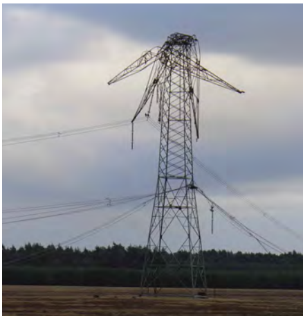
Sturmschaden durch den Orkan Kyrill im Jahr 2007
